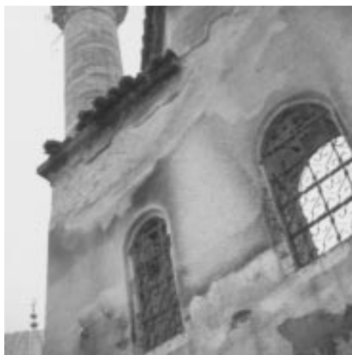
Fig. 59. Badiyar (Kashmir), "Lal Ded Memorial School Library". Il biodeterioramento nelle biblioteche e negli archivi è favorito dalla carenza o dall'assenza della manutenzione ordinaria.
